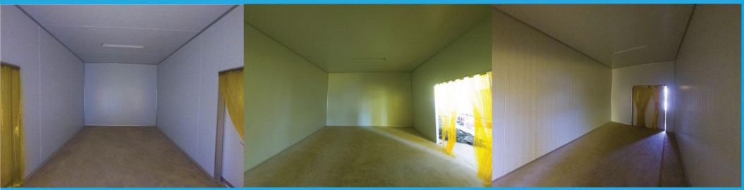
รูปผนังสำเร็จรูปภายในห้องเย็น
