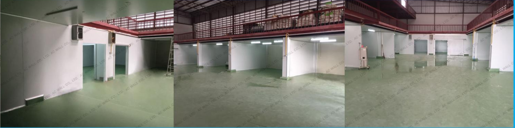
รูปผนังสำเร็จรูปด้านนอกห้องครีนรูม
